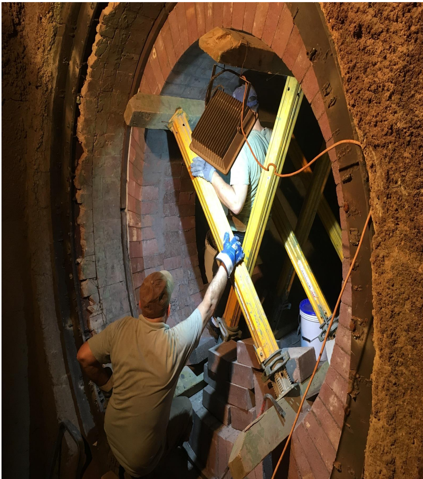
Φωτό 1060: Πυρίμαχη επένδυση κλιβάνου
