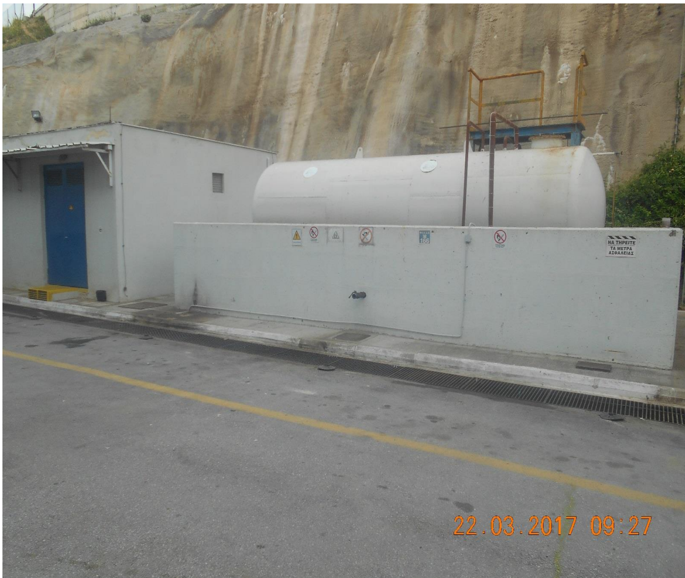
Φωτό 1245: Δεξαμενή πετρελαίου
