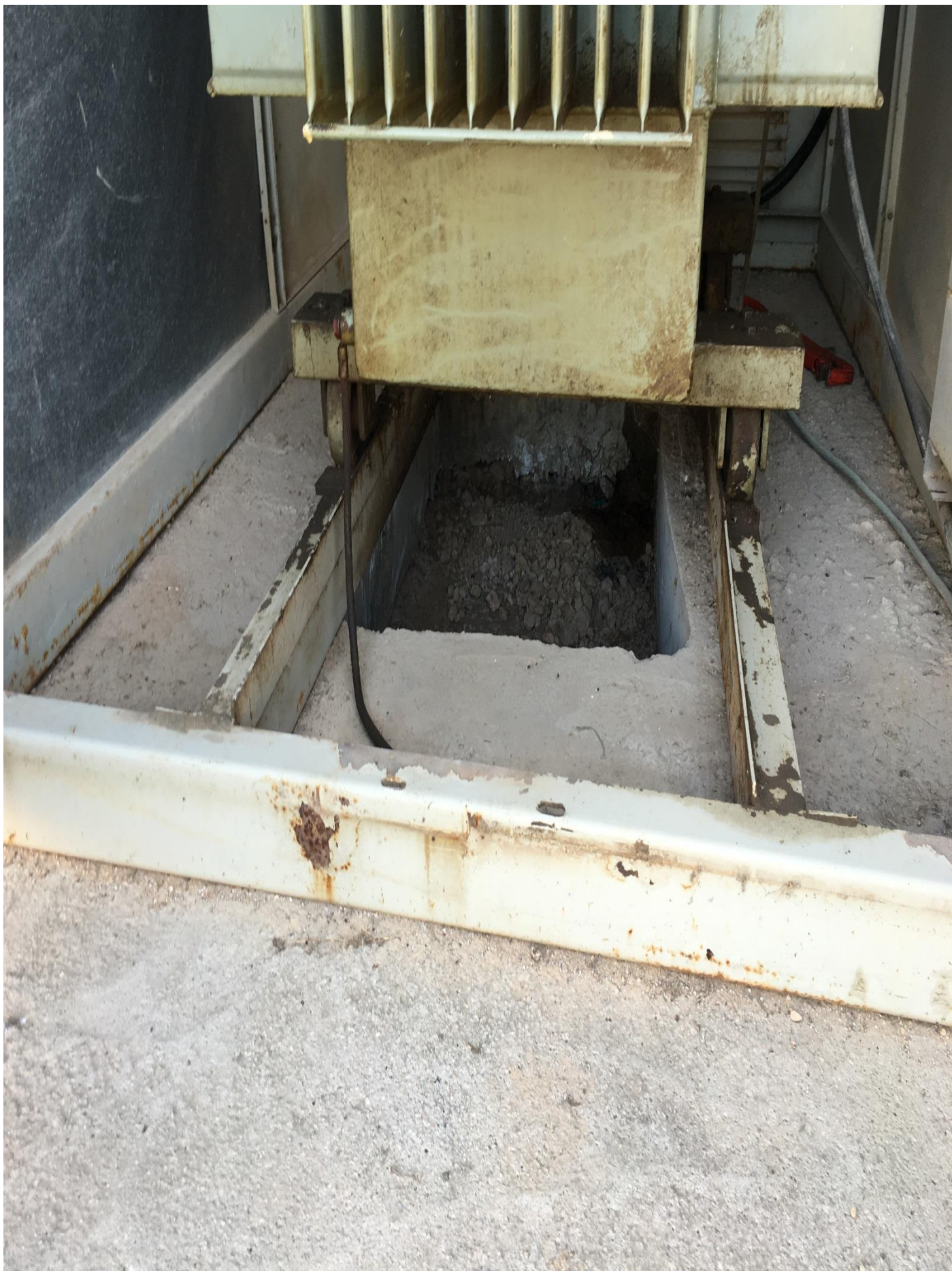
Φωτό 0783: Ελαιολεκάνη στο χώρο του μικρού υποσταθμού
