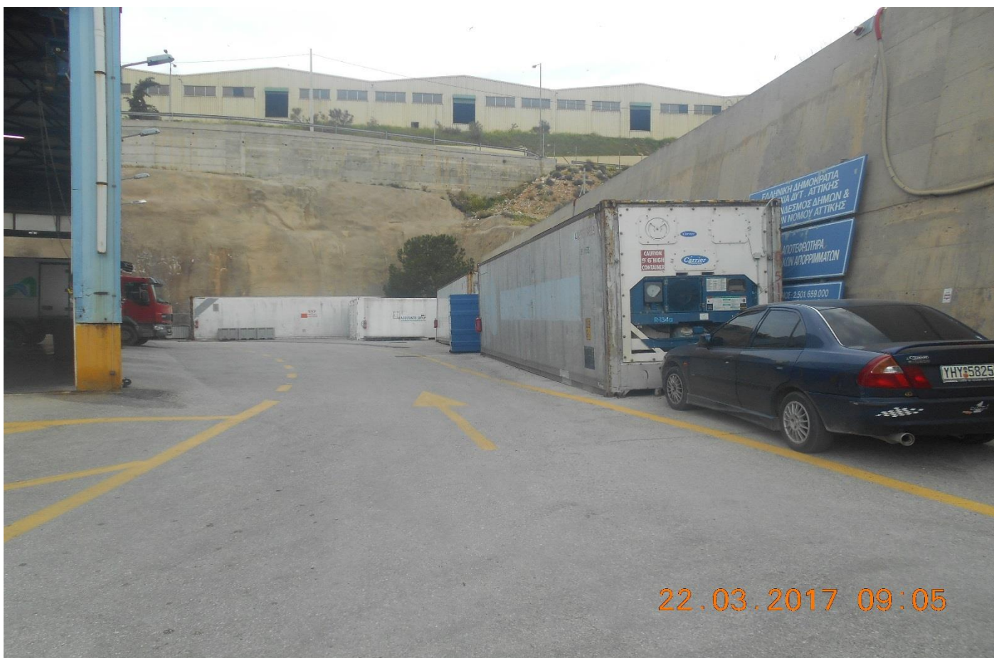
Φωτό 1210: Εφεδρικές ψυκτικές μονάδες αποθήκευσης μολυσματικών (containers)
