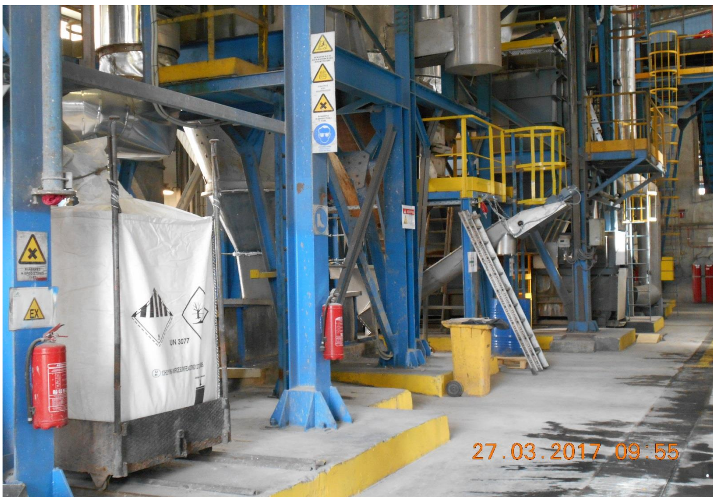
Φωτό 1322: Σήμανση ασφαλείας εσωτερικά της μονάδας και πυροσβεστικά μέσα
