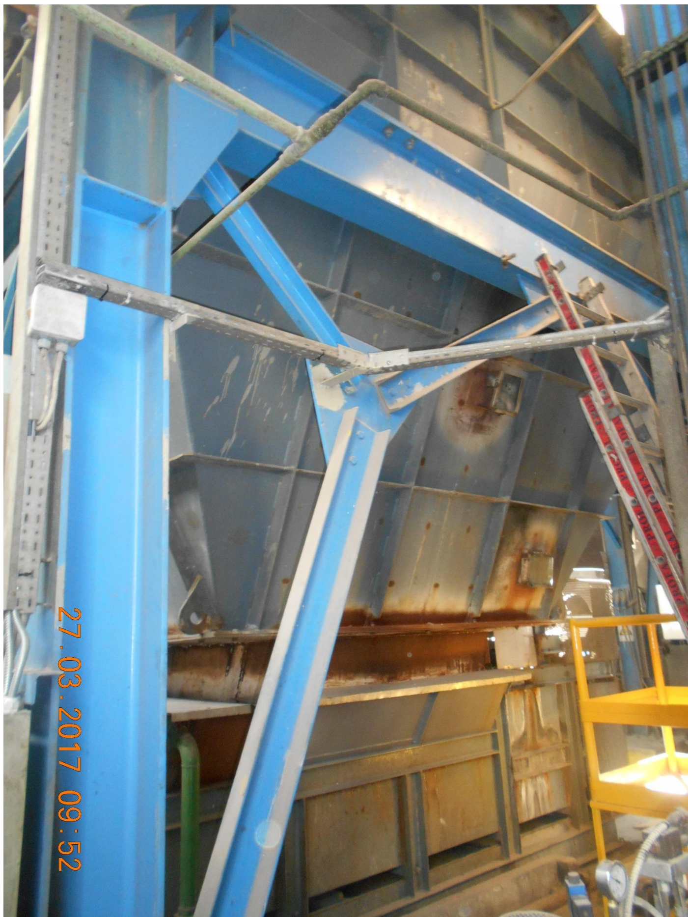
Φωτό 1314: Θάλαμος τέφρας και θάλαμος μετάκαυσης
