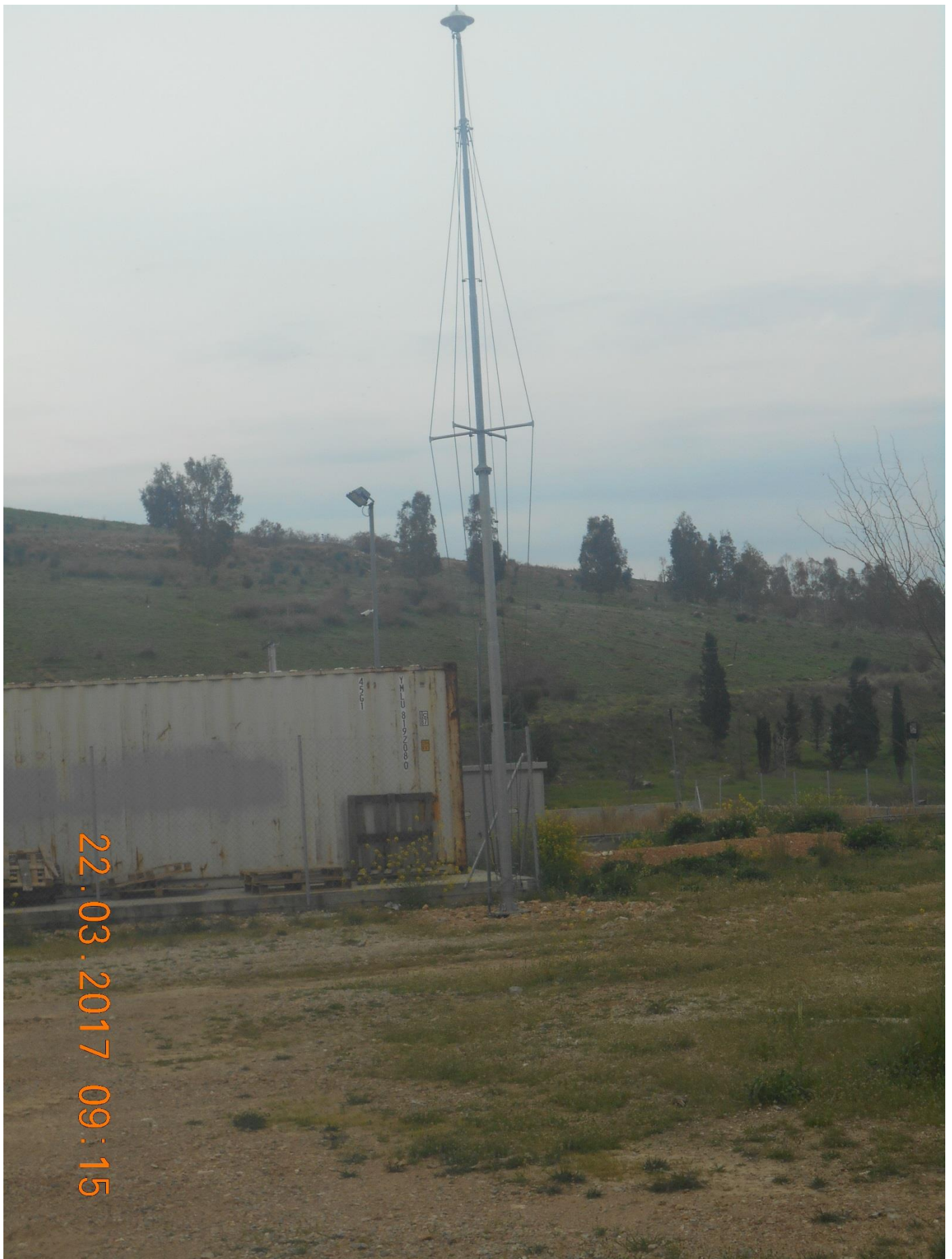
Φωτό 1224: Αλεξικέραυνο προστασίας στο χώρο προσωρινής αποθήκευσης τέφρας
