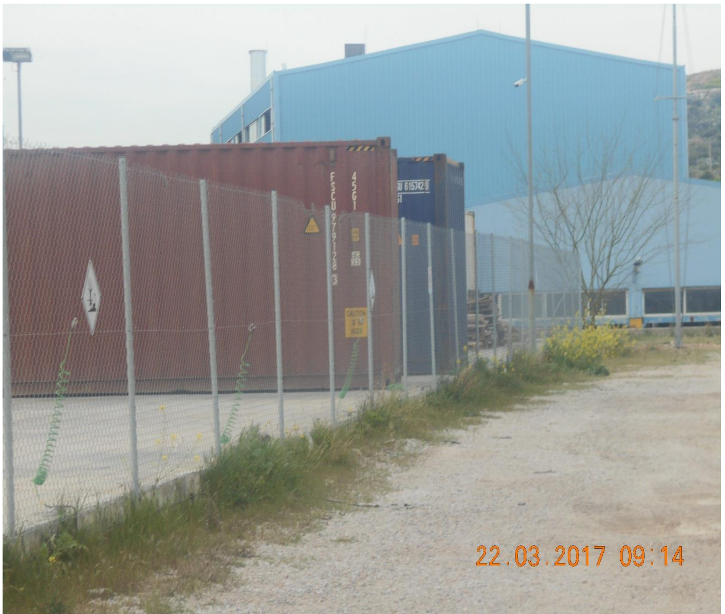
Φωτό 1222: Γειώσεις σε κάθε container στην πλατφόρμα προσωρινής αποθήκευσης τέφρας
