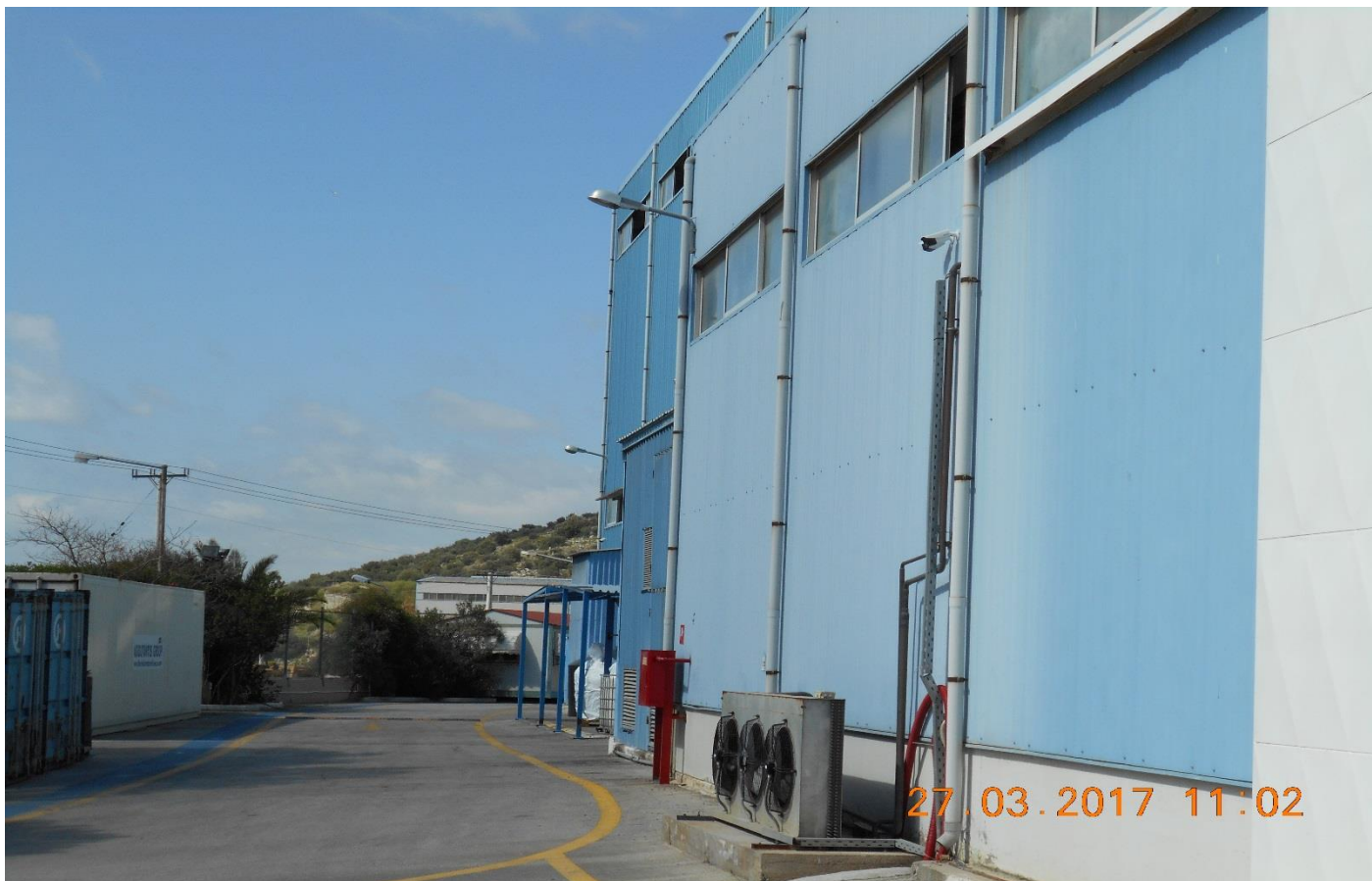
Φωτό 1337: Πυροσβεστική φωλιά
