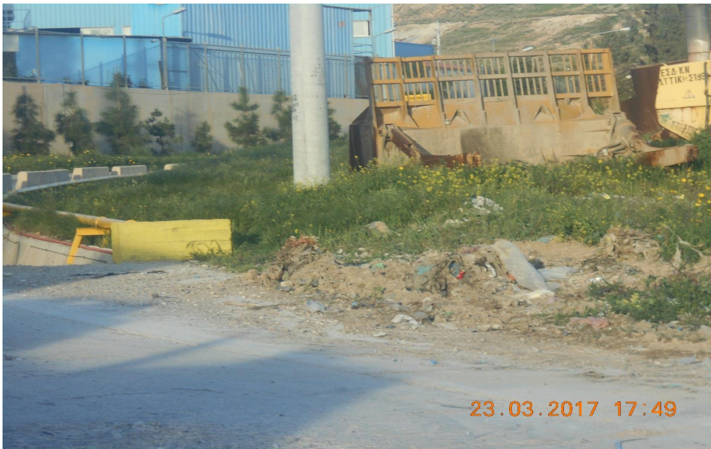
Φωτό 1285: Τοιχίο για την ασφάλεια της σωλήνωσης φυσικού αερίου
