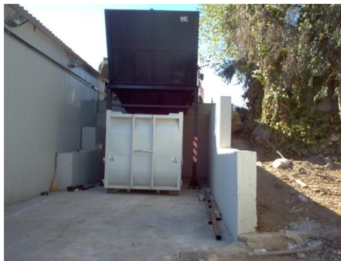
Φώτο 11: Άποψη της χοάνης επάνω από το πλατώ εκφόρτωσης των απορριμματοφόρων
