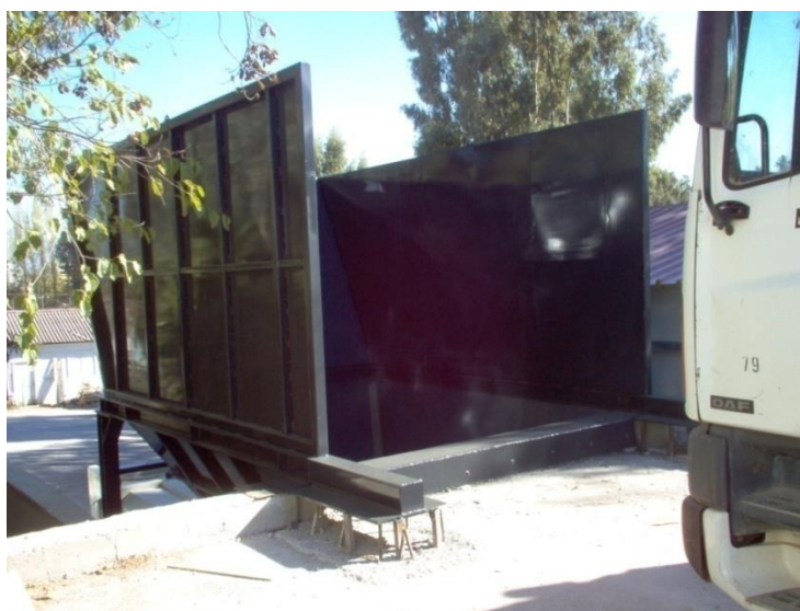
Φώτο 10: Άποψη της χοάνης επάνω από το πλατώ εκφόρτωσης των απορριμματοφόρων
