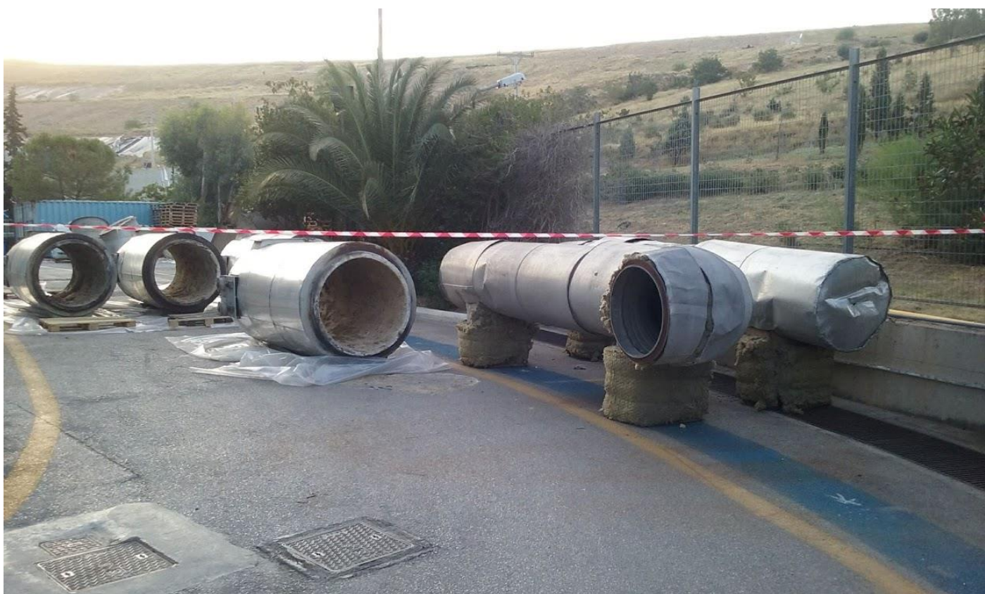
Φωτο 12Γ: Στοιχεία εναλλακτών θερμότητας και αεραγωγοί
