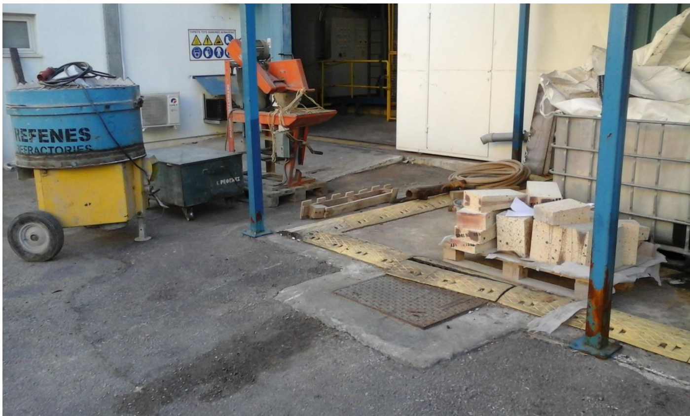
Φωτο 27: Εξοπλισμός κοπής πυρότουβλων κλιβάνου καύσης
