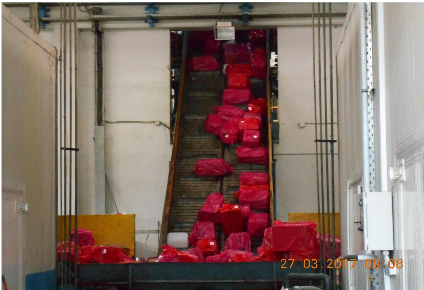
Φωτό 77: Ανυψωτικές ταινίες εισερχομένων ΕΑΥΜ στον κλίβανο
