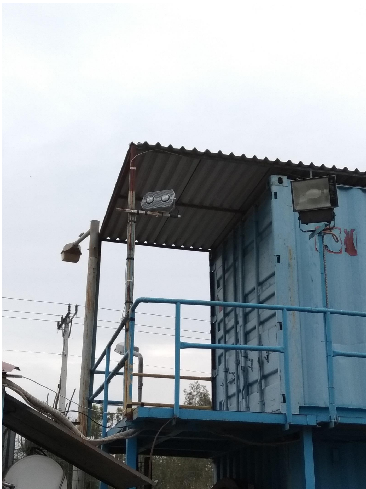
Φωτο 90: Προβολέας φωτισμού πληροφοριακής πινακίδας εγκατάστασης αποτεφρωτήρα
