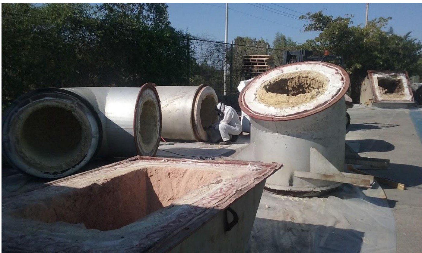
Φωτο 12B: Στρογγυλή διαστολή μετάκαυσης, καμπύλη εναλλάκτη και εργασίες καθαρισμού από επικαθήσεις
