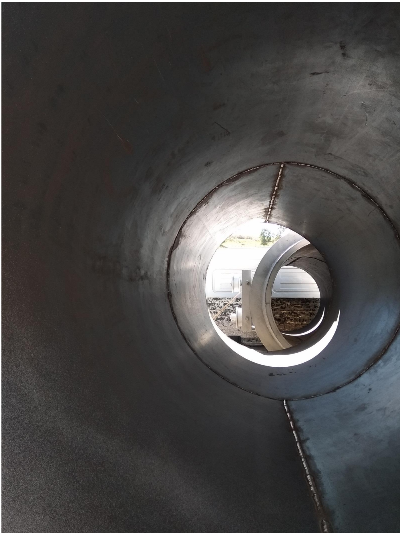
Φωτο 52: Εσωτερική κάτοψη εναλλακτών θερμότητας μετά από ολική συντήρηση
