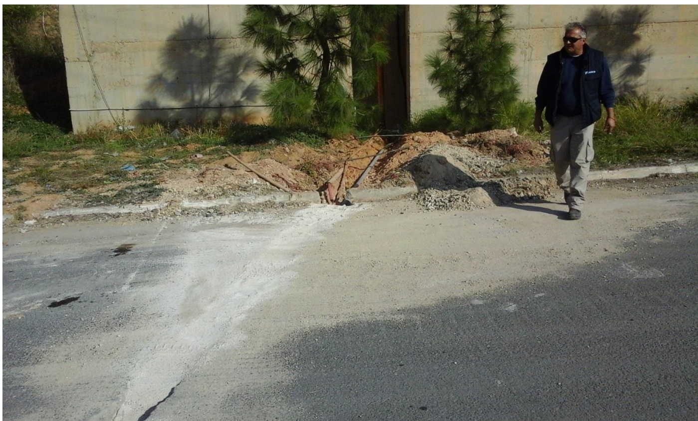
Φωτο 37: Νέα καλωδίωση ΟΤΕ
