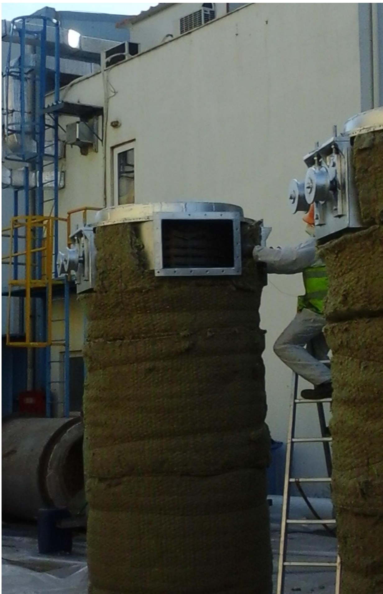
Φωτο 33: Νέα επένδυση αεραγωγού εναλλάκτη θερμότητας
