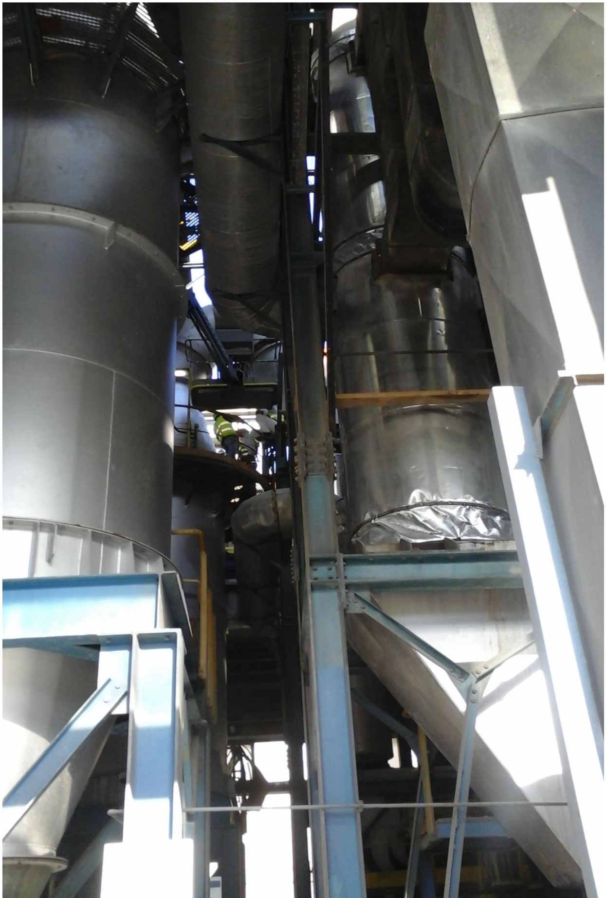
Φωτο 7: Επισκευασμένος εναλλάκτης Β γραμμής
