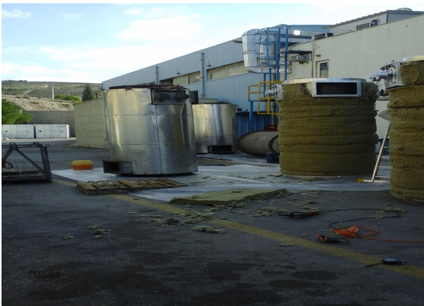
Φωτο 35: Νέα επένδυση στοιχείων εναλλάκτη θερμότητας
