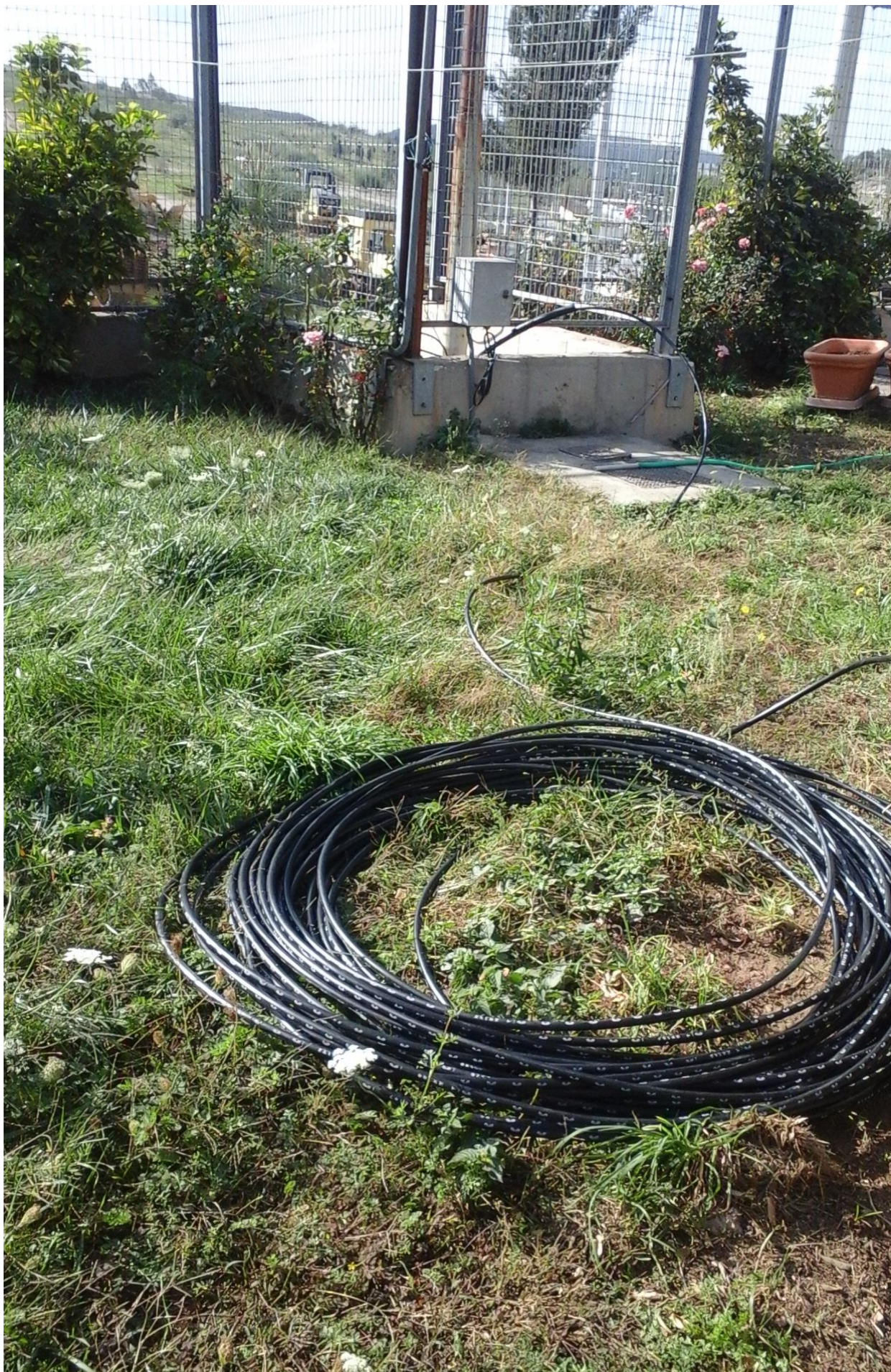
Φωτο 36: Νέα καλωδίωση ΟΤΕ
