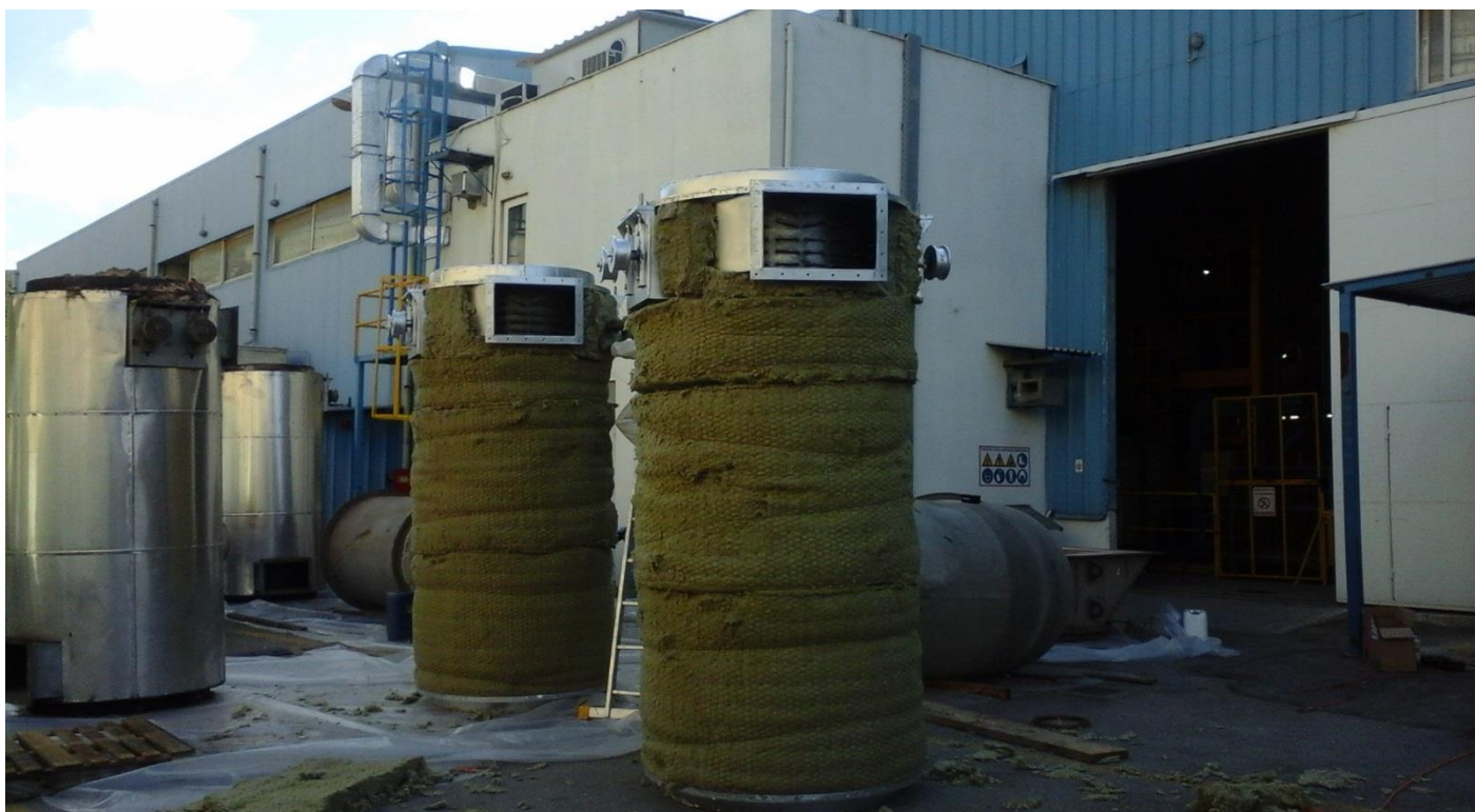
Φωτο 34: Νέα επένδυση στοιχείων εναλλάκτη θερμότητας
