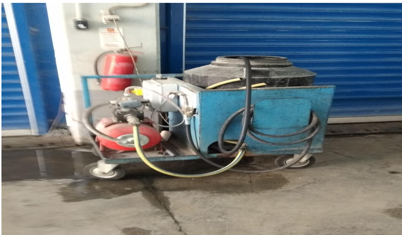
Φωτο 73: Δεξαμενή – μοτέρ απολύμανσης
